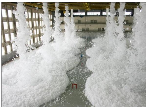
Рисунок 4 – Работающая спринклерная установка пожаротушения
