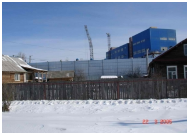
Рисунок 1 – Шумозащитный экран, установленный вблизи строительной площадки, Ленинградская область
