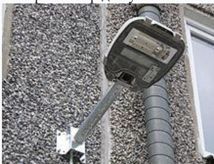
Освещение двора многоквартирного дома светодиодным консольным светильником
