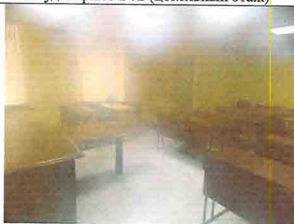
Фото № 153 Влажность в аудитории № 02 (цокольный этаж)
