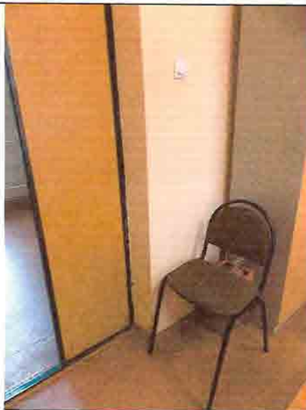
Фото № 148 Выключатель в аудитории № 13
