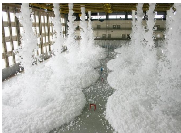
Рисунок 4 – Работающая спринклерная установка пожаротушения
