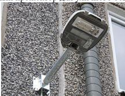
Освещение двора многоквартирного дома светодиодным консольным светильником
